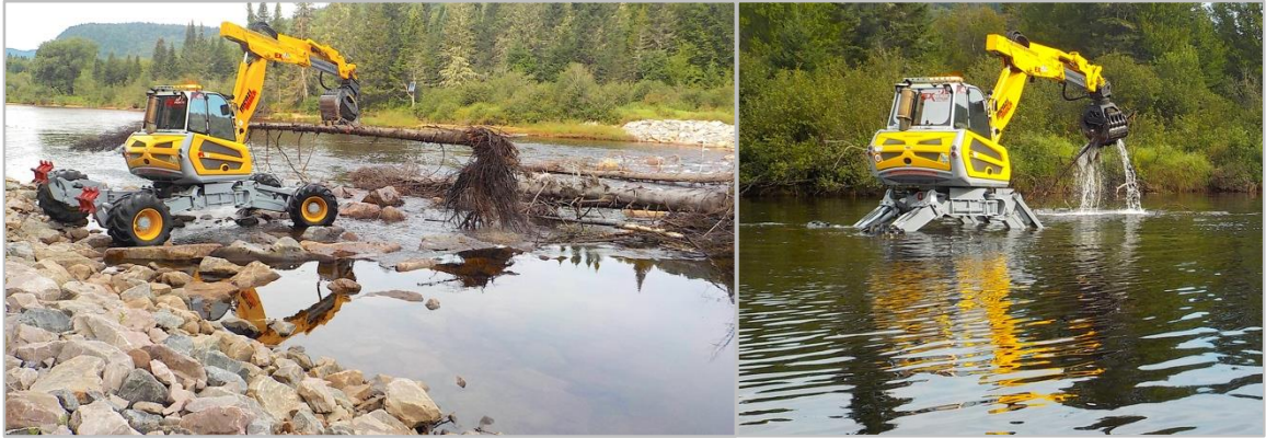
Figure 43 : Enlèvement de débris de bois et d'arbres entiers au site du PK 24 le 19 août 2021.
