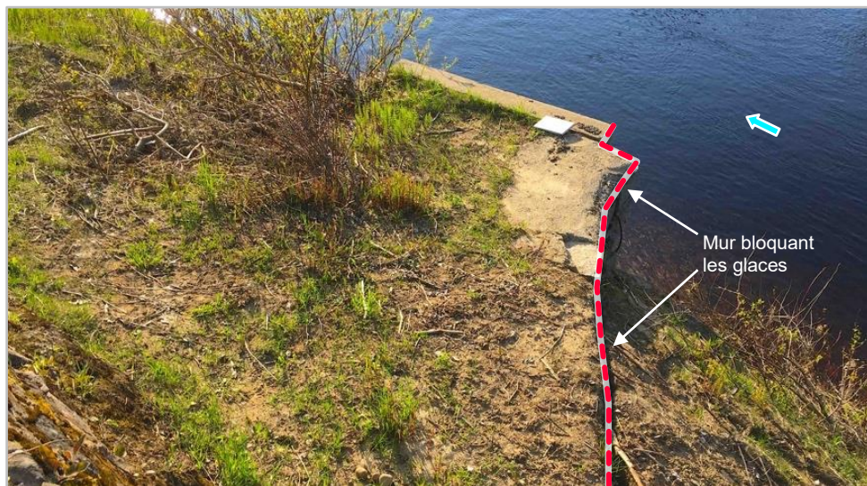
Figure 74 : Émissaire avec mur et maçonnerie de béton en saillie, haute de 2,4 m, le 29 mai 2019.
