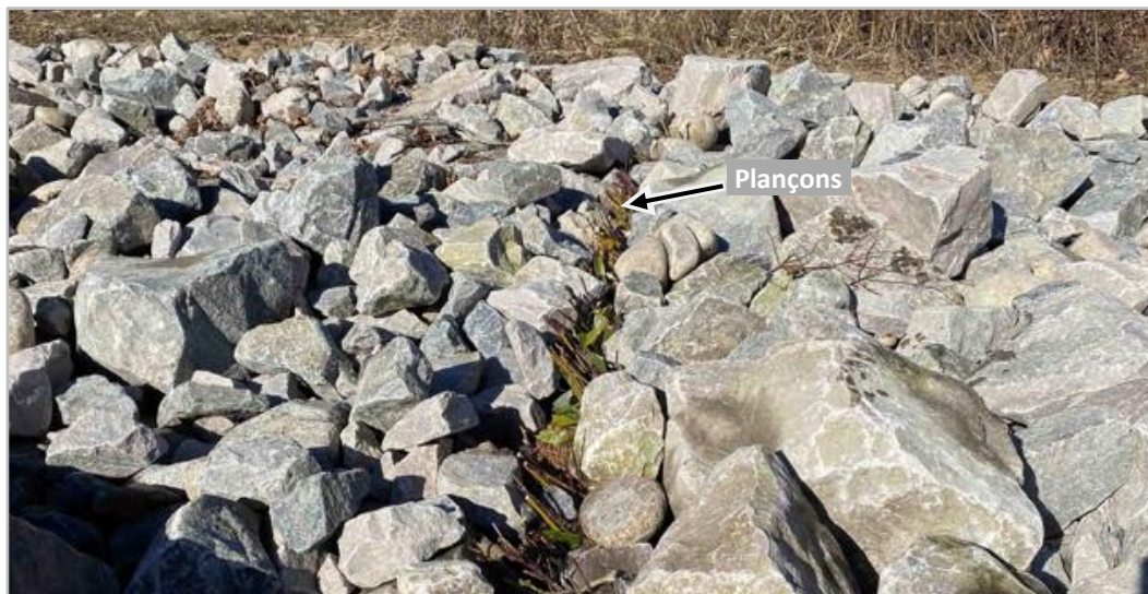
Figure 109 : Plançons protégés de la glace par des pierres de 150 à 800 mm (27 octobre 2022).
