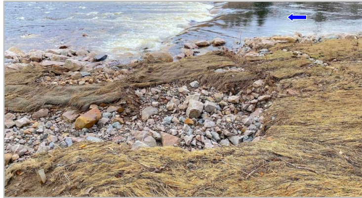
Figure 45 : Dommages à la petite intervention de génie végétal au PK 24 le 25 avril 2024.
