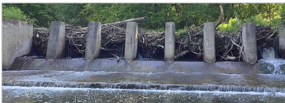
Figure 102 : Débris accumulé sur les piliers d'une estacade en ligne droite dans la rivière Duberger (11 juin 2020).
