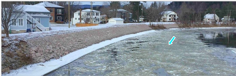
Figure 67 : Digue et enrochement deux jours après la crue de Noël 2020 (27 décembre).
