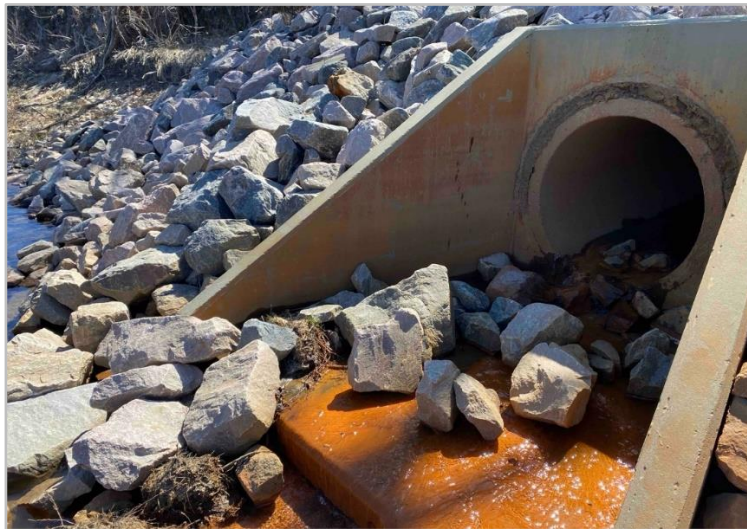
Figure 81 : Pierres de l'enrochement déplacées par la glace à replacer (photo du 25 avril 2024).
