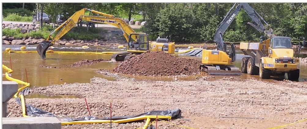
Figure 92 : Dragage par excavation du lit de la rivière et chargement des camions hors routes.
