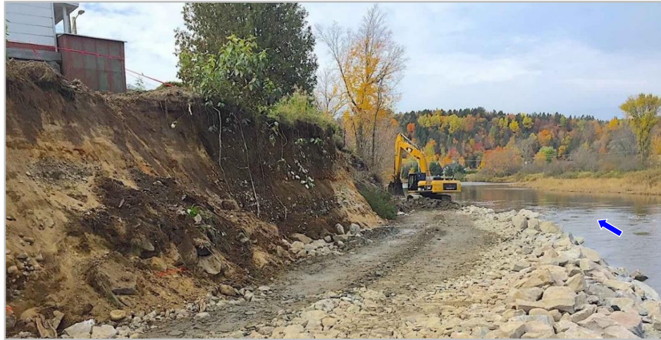
Figure 16 : Crête du talus érodé à 1 m de la résidence #740 avenue Beaulieu.
