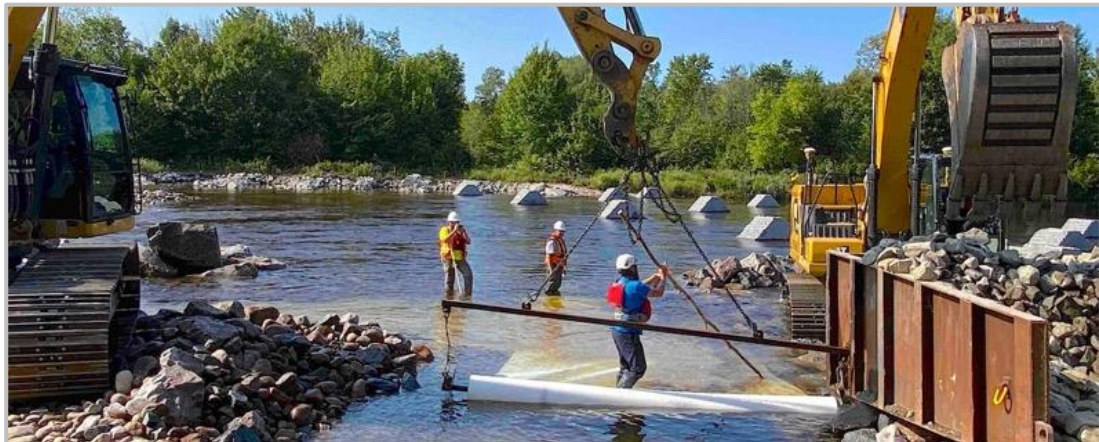
Figure 107 : Déroulage du géotextile appuyé sur la face amont du rang de blocs (6 septembre 2022).
