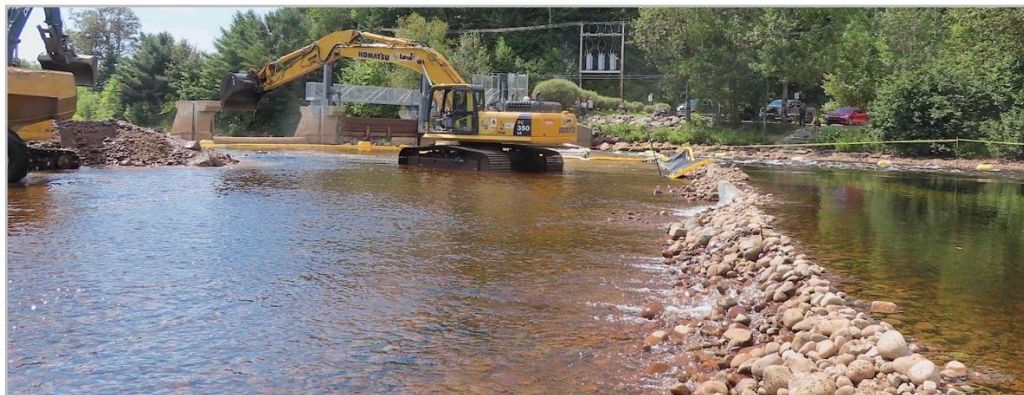
Figure 91 : Andain de galets et blocs issus du lit de la rivière avec quelques blocs de béton.
