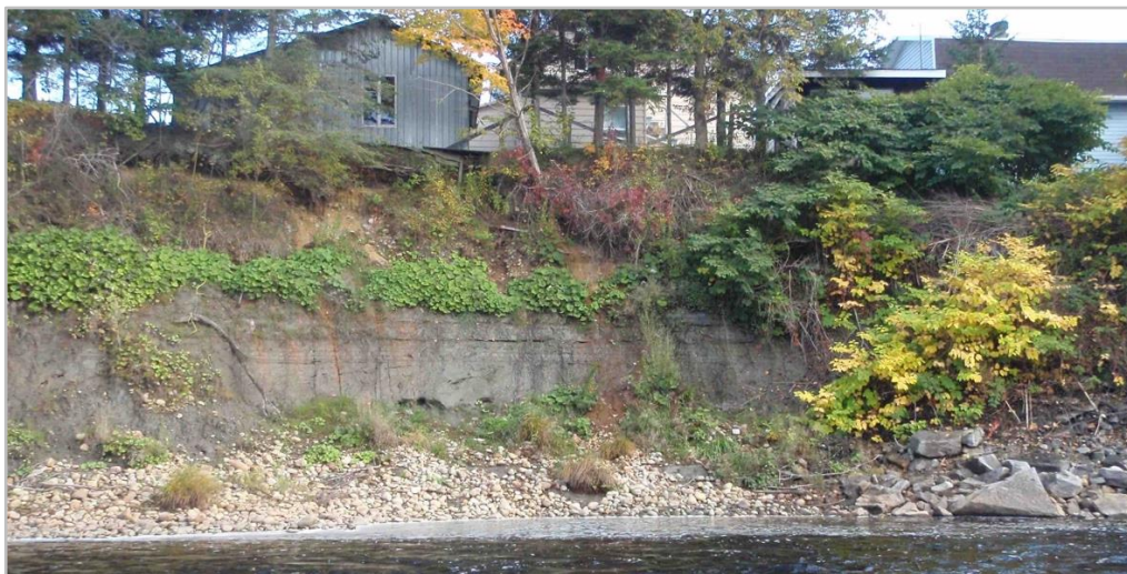
Figure 15 : Talus affecté par un glissement de terrain à moins de 6 m de la résidence #789-791.
