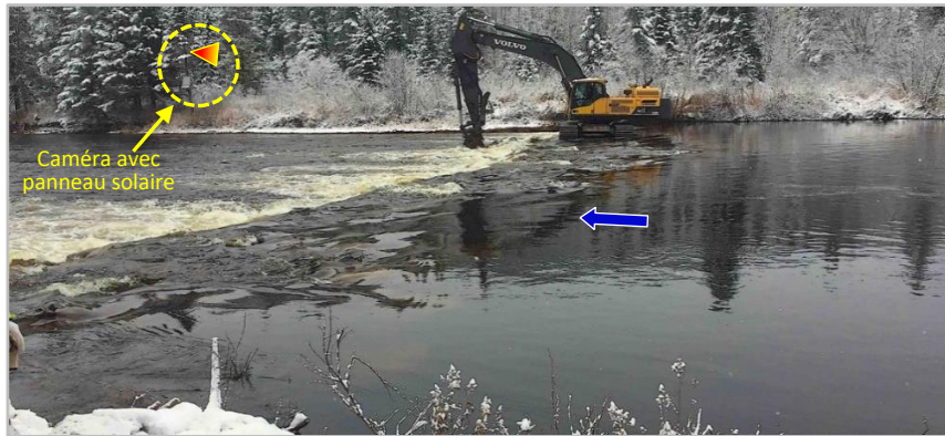
Figure 32 : Mise en place des blocs rocheux sous la forme d'une berme de travail le 7 novembre 2019.
