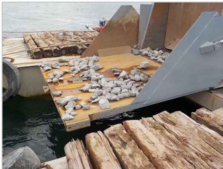
Figure 53 : Mur poussoir actionné. Photo d'un autre projet prise en 2019 au lac Saint-Louis.
